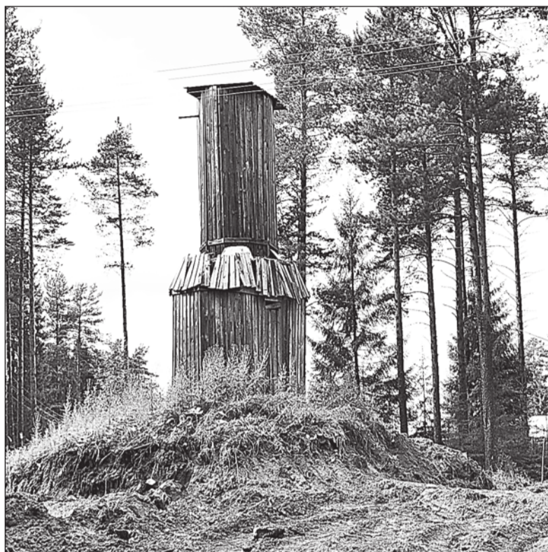
Водонапорная башня на улице Зелёная требует ремонта
