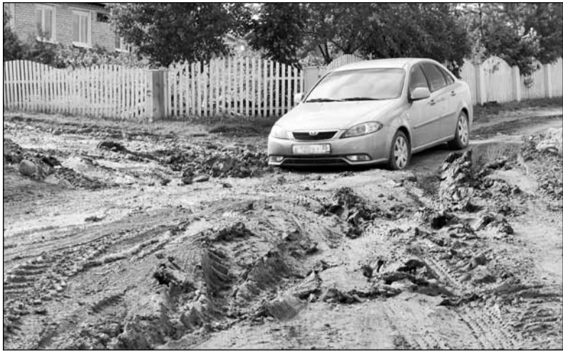
Последствия прокладки газораспределительных сетей
